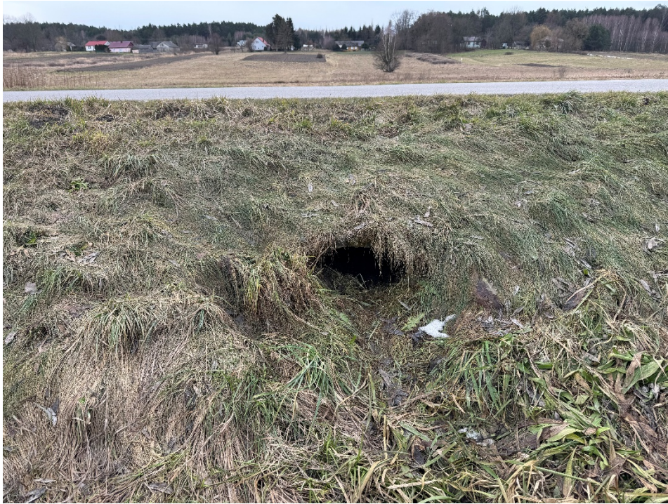
Fot. 9 Przepust zlokalizowany pod drogą na wysokości działki 910/6 widok w stronę źródeł Jacynki po przeciwnej stronie drogi
