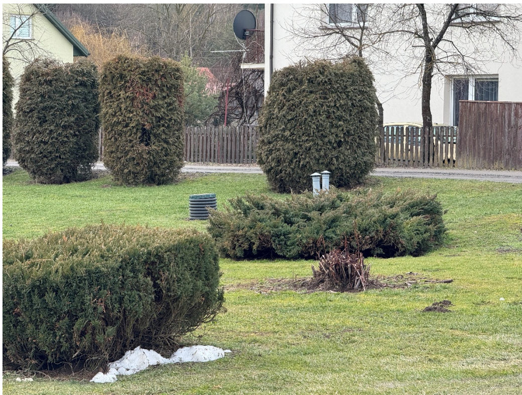
Fot. 12 Oczyszczalnia działka 891/1
